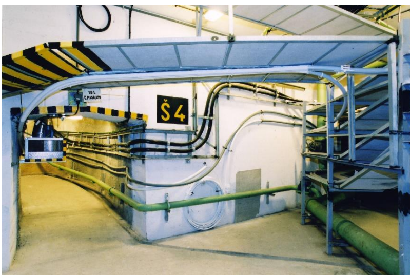
Obr. 1 Křížení sítí v kolektorové šachtě
