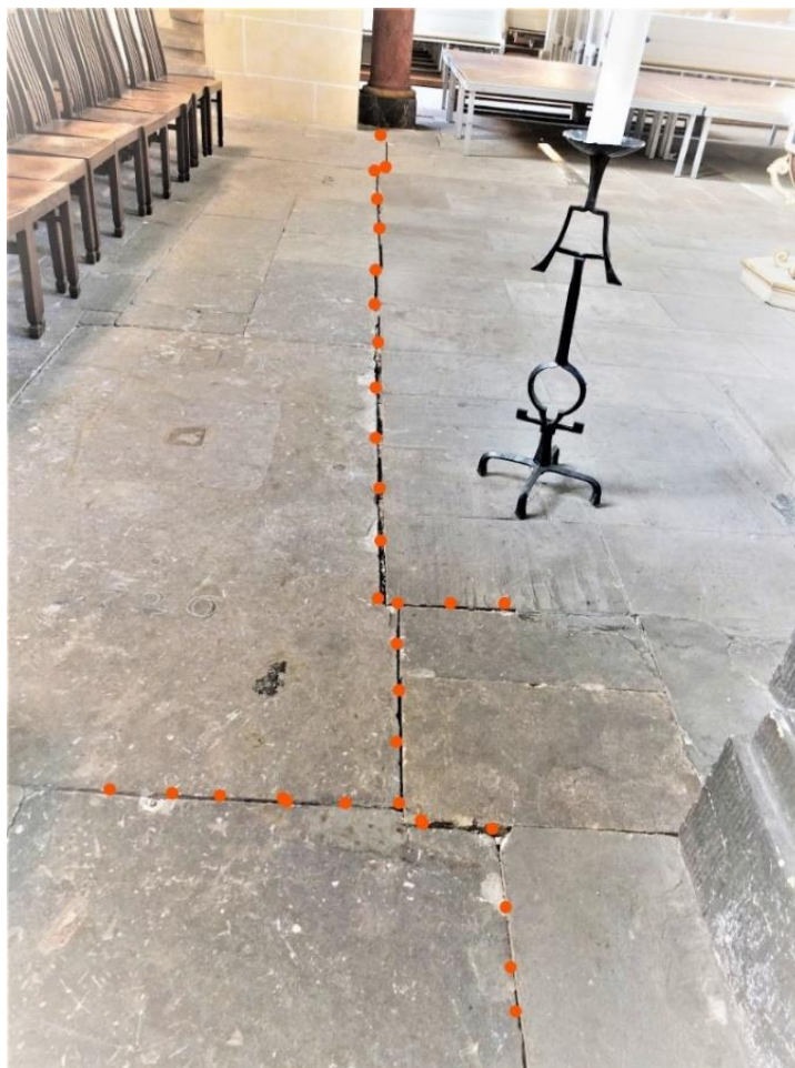
Obr. 11 Trhliny v podlaze před oltářem
