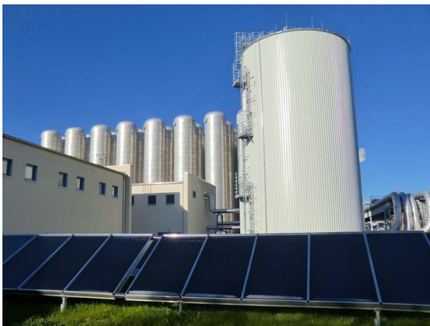
Obr. 5 Solárně termické zařízení se zásobníkem tepla
