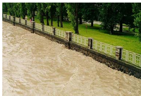
Obr. 3 Opěrné nábrežní zdi, průtok 7. 7. 1997 při kulminaci Ostravice
