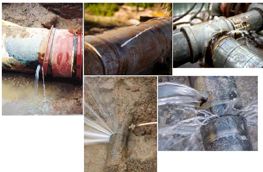
Obr. 6 Úniky vody vplyvom korózneho prederavenia steny potrubia a spojov [12][13]
