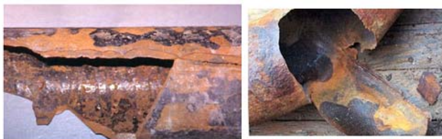
Obr. 1 Pozdĺžne prelomenie časti skorodovanej steny potrubia [15]
