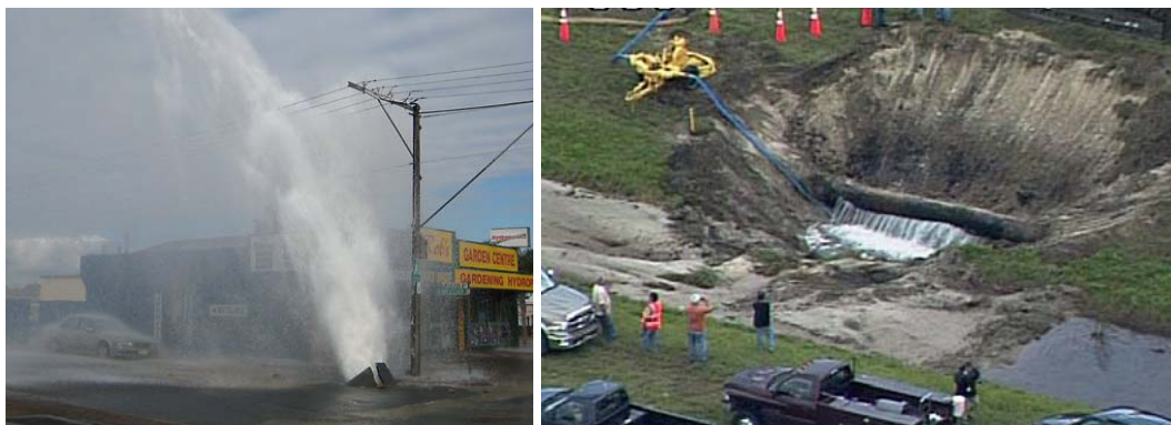
Obr. 1 Poruchy na vodovodnom potrubí. [10]
