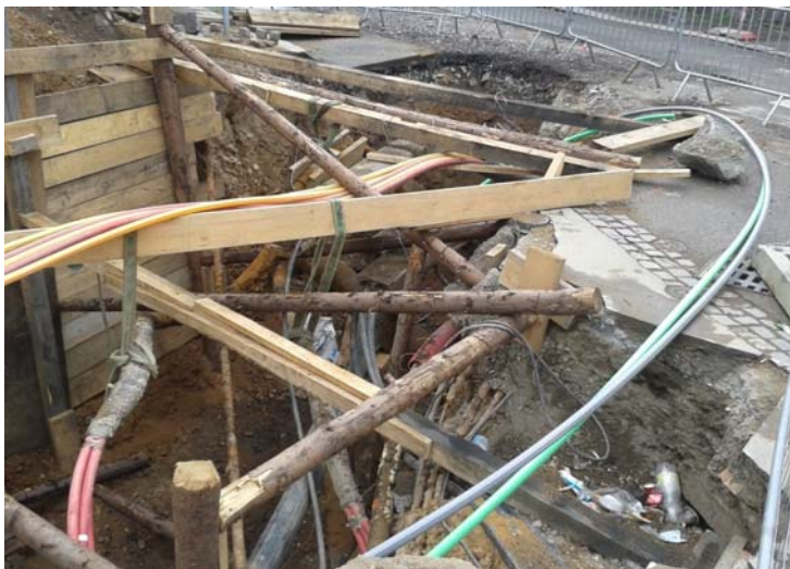
Obr. 6 Demonstrační obrázek – často se vyskytující nebezpečný zmatek v podzemí areálů je dnes bohužel příliš častým jevem
