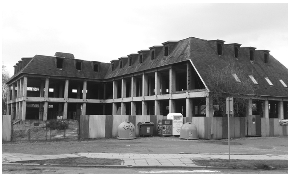
Obr. 2 Pohled na chátrající skelet (listopad 2015)
